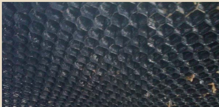
Abb. 7 Kühlturm des Pasteurs mit DK-DOX® Chlordioxid betrieben
